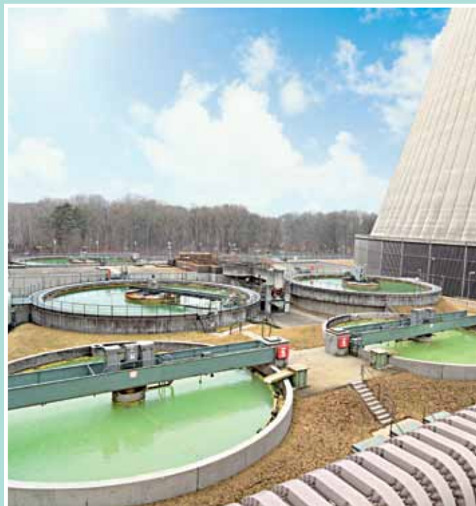
Das Donauwasser für den Kühlturmkreislauf wird zunächst gereinigt und entkalkt. Der Kalk dient Landwirten als Dünger.
