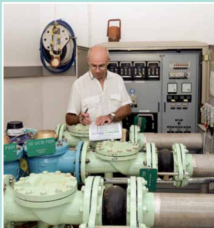
Ein Tiefbrunnen sichert die Trinkwasserversorgung für das Kraftwerk und die Gemeinde Gundremmingen.
